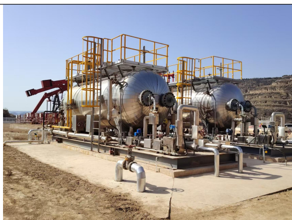
岭67增脱水系统装置
