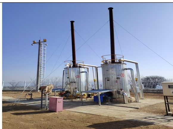
卸油台加热炉
